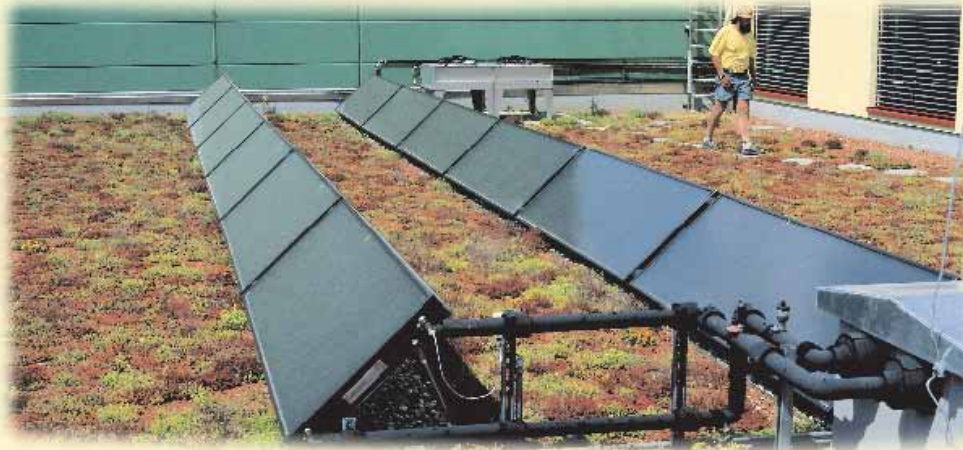
Solarthermie-Anlage auf dem Dach der Ensinger Mineralquellen
